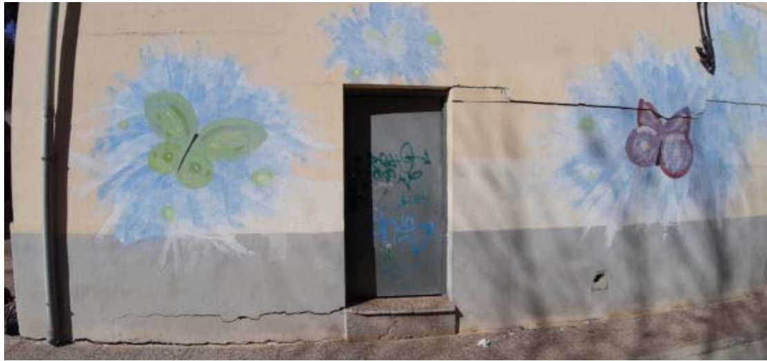
Imagen 13. Edificio Secundario. Vista fachada este; detalle cerramiento agrietado
