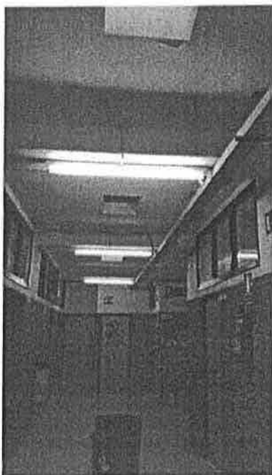
Entrada de agua
