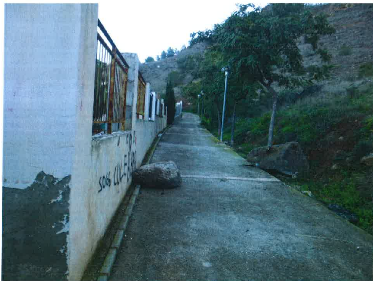
Bloques de piedra desprendidos y caídos como consecuencia de las lluvias
